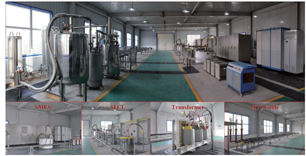
図 1.1 超電導変電所（中国甘粛省白銀市）
